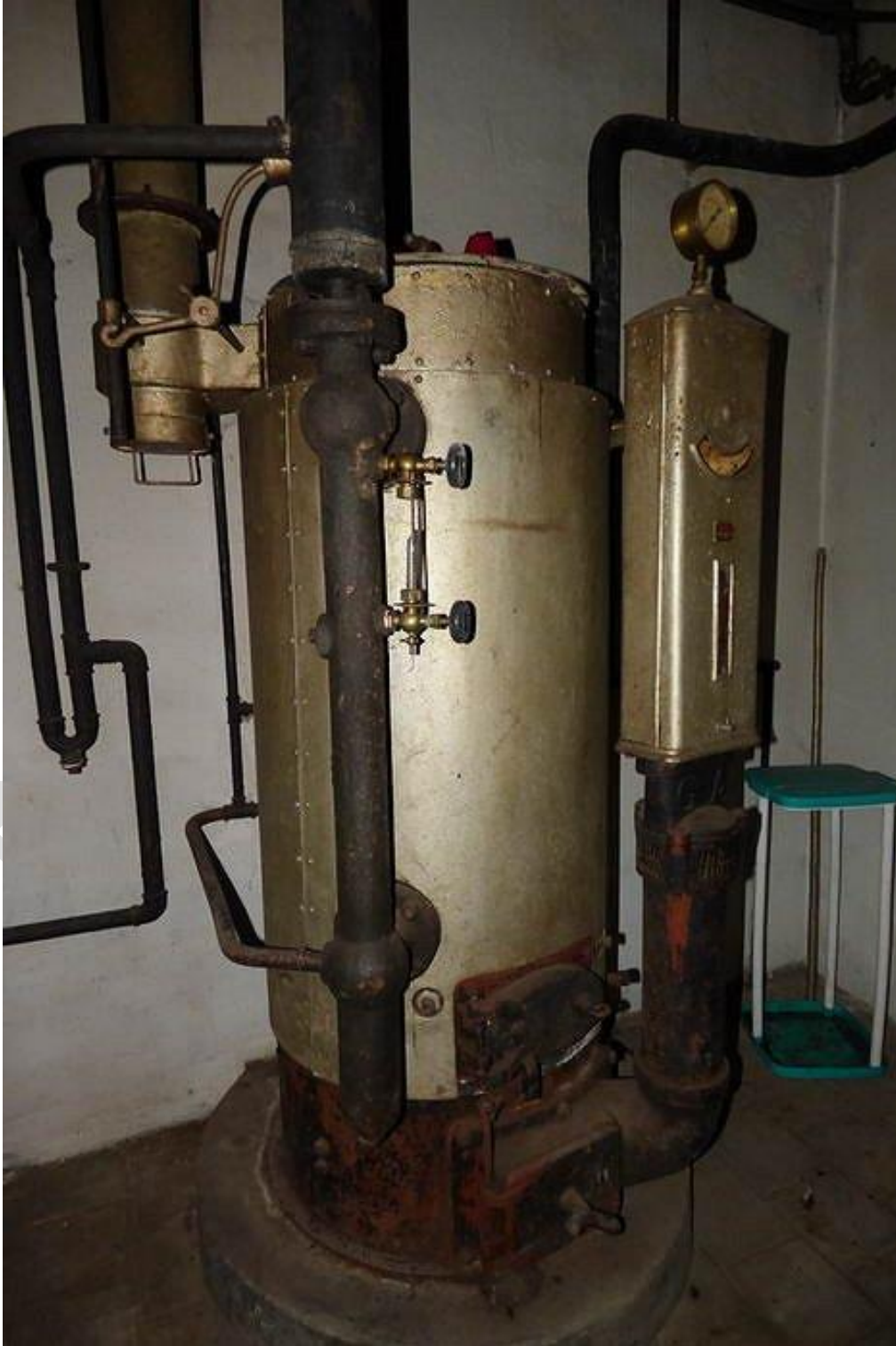
Figure 1 Chaudière à vapeur de l'abri du bois de Cattenom
